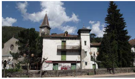
Etat d'abandon d'édifices près des Peupliers au Caslmaou, hôtel de la Paix place du Breilh
